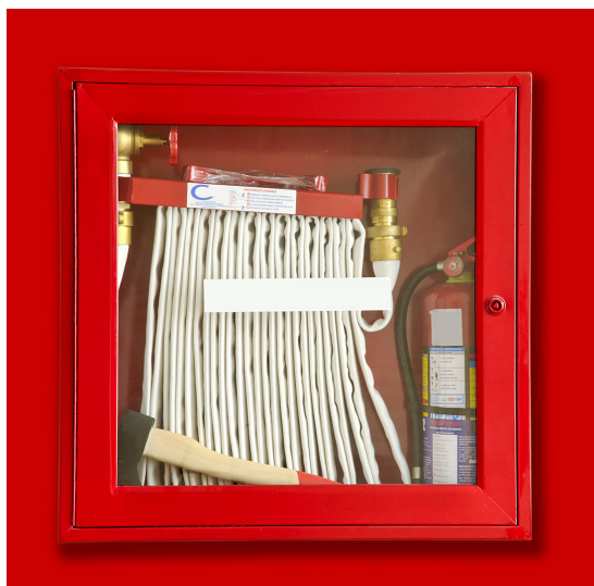
Hidrante de 1 saída de água
